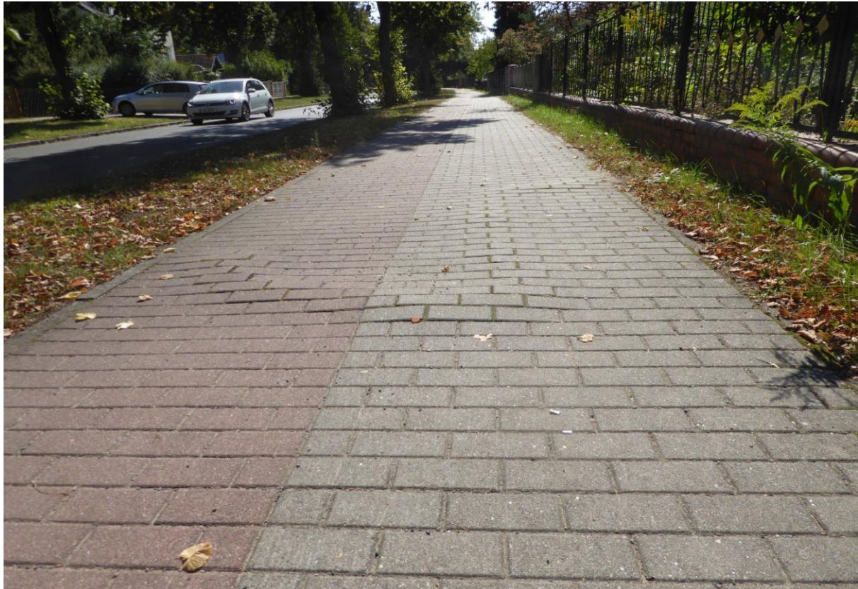
Abb. 26: Pflasterhebungen durch Baumwurzeln in der Schillerstraße
