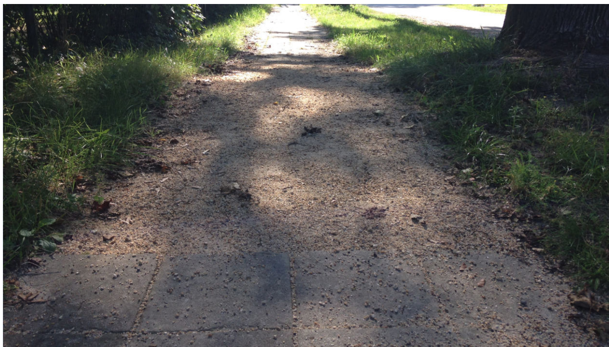
Abb. 30: Gehwegerhöhungen bei Ausbesserungen mit Befestigungsmaterial ohne Bindemittel
