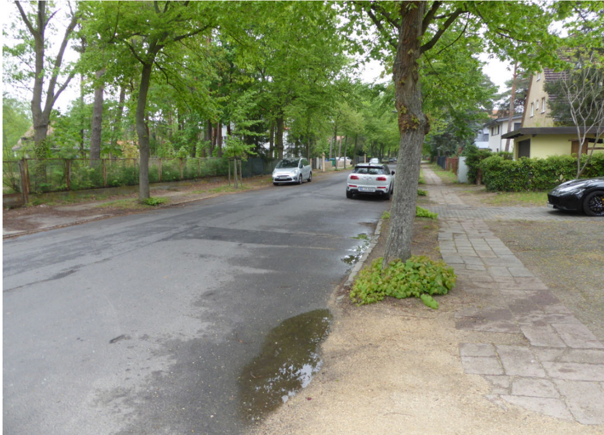
Abb. 8: Schlechter Zustand des Betonplattenbelages in der Havellandstraße
