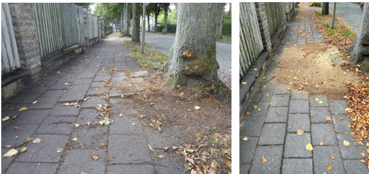
Abb. 24: Beispielhafte Abbildung von Gehwegschäden durch Baumwurzeln und erfolgte Sanierung
