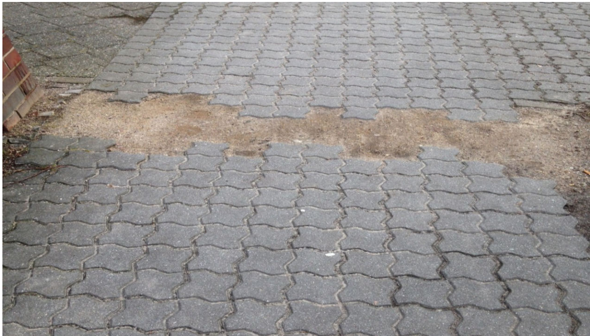
Abb. 29: Abrieb im Gehwegbereich bei ausgebessertem Pflaster mit Befestigungsmaterial ohne Bindemittel
