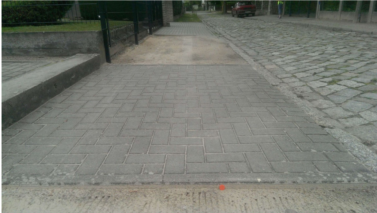
Abb. 27: Höhenversätze an Übergängen zu Grundstückszufahrten von mehreren Zentimetern
